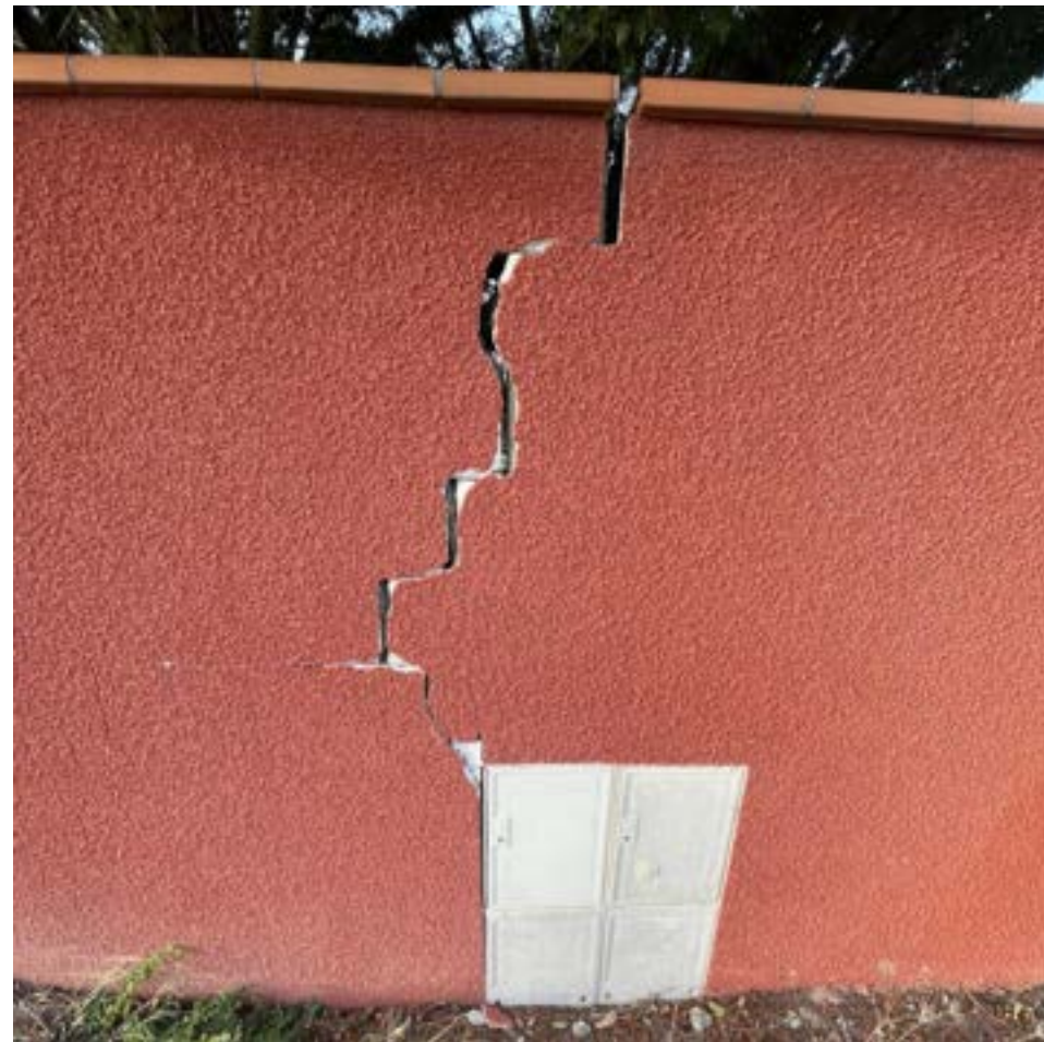
Figure 60 : Mur fissuré en raison de mouvements de terrain induits par la rétractation et le gonflement du sol argileux (photographie prise hors commune)
